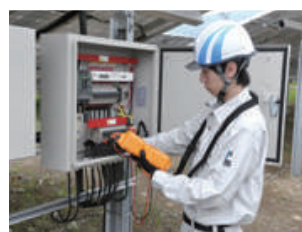
パワーコンディショナの点検・交換
