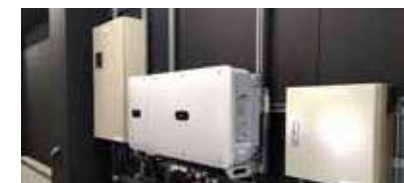
AC出力50kWの高効率パワーコンディショナを中心に、計器盤(左)、遠隔監視装置「ソラジット2」(右)を配置
